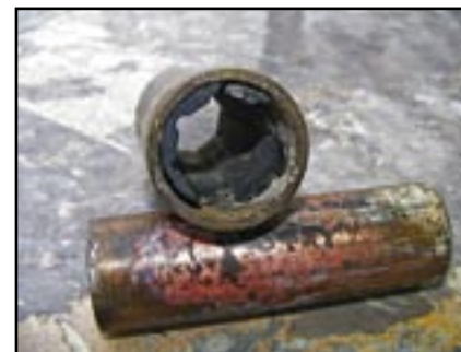
7: Izjemno poškodovan oz. izrabljen gumijasti ležaj.
