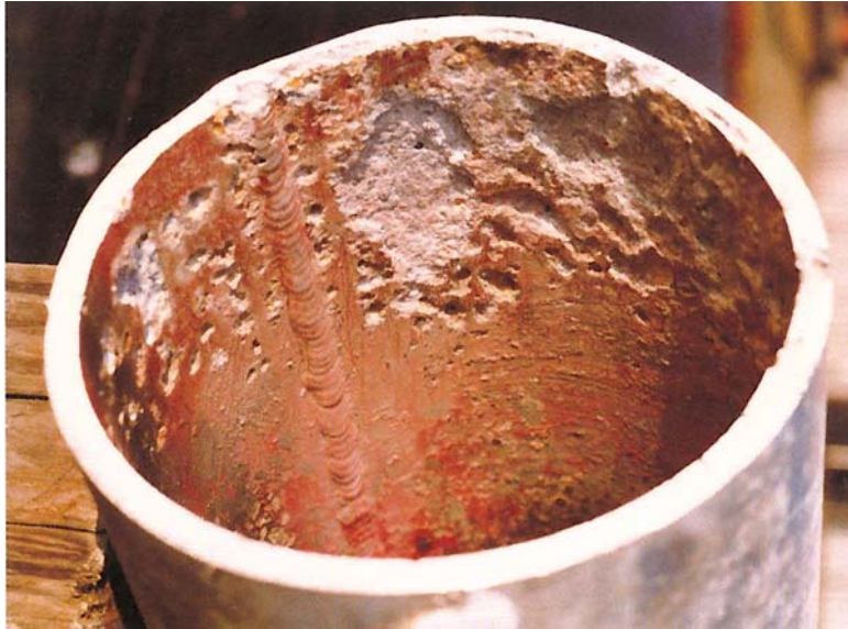
Slika 8: Korozija statvene cevi
