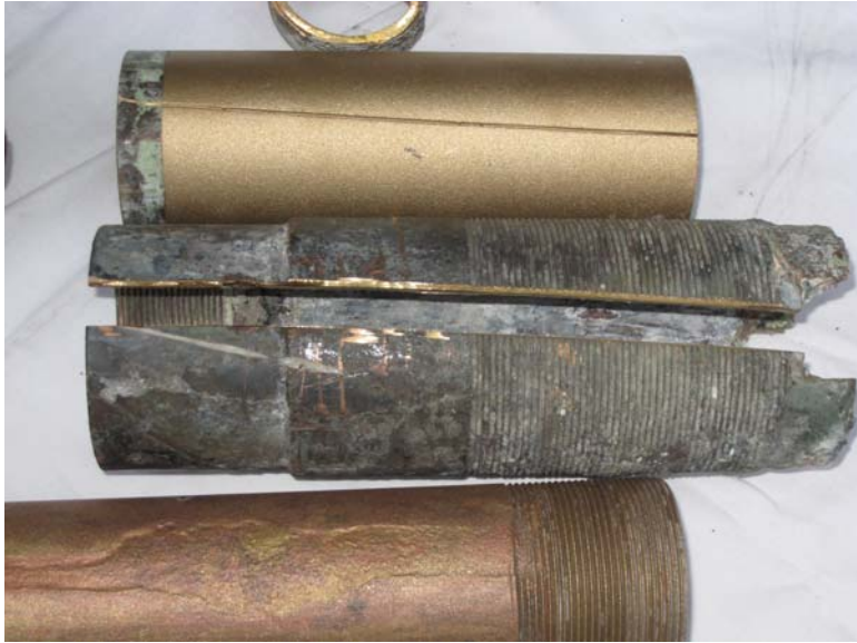
Slika 7: Korozijske poškodbe na statveni cevi in reducirnih elementih
