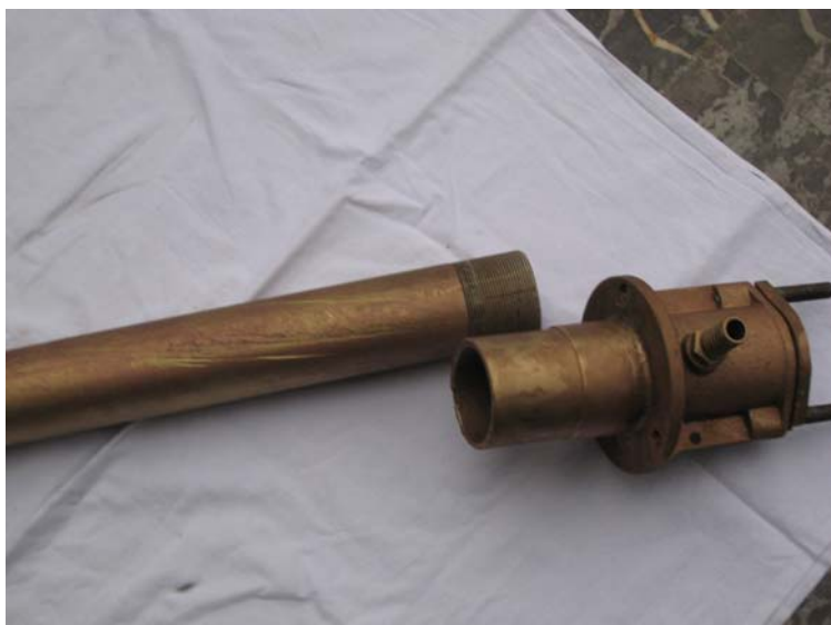
Slika 6: Star tesnilni sistem s statveno cevjo – slaba kakovost (korozijske poškodbe)
