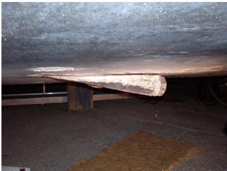
Slika 5: Statvena cev pri motornem čolnu – potrebna zamenjave
